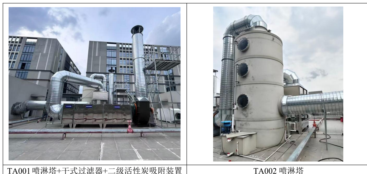
图 4-2 废气治理设施
