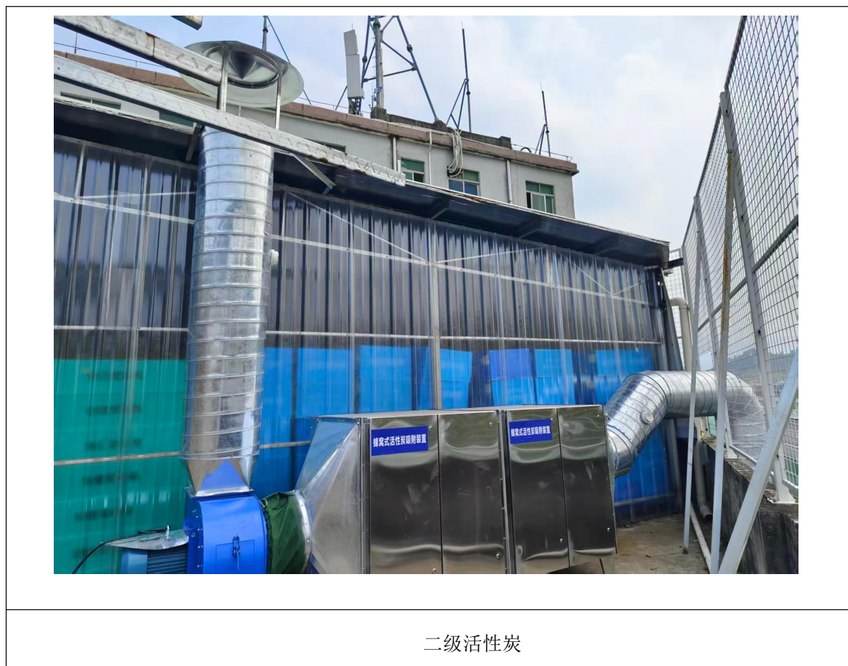
图 4-2 废气治理设施
