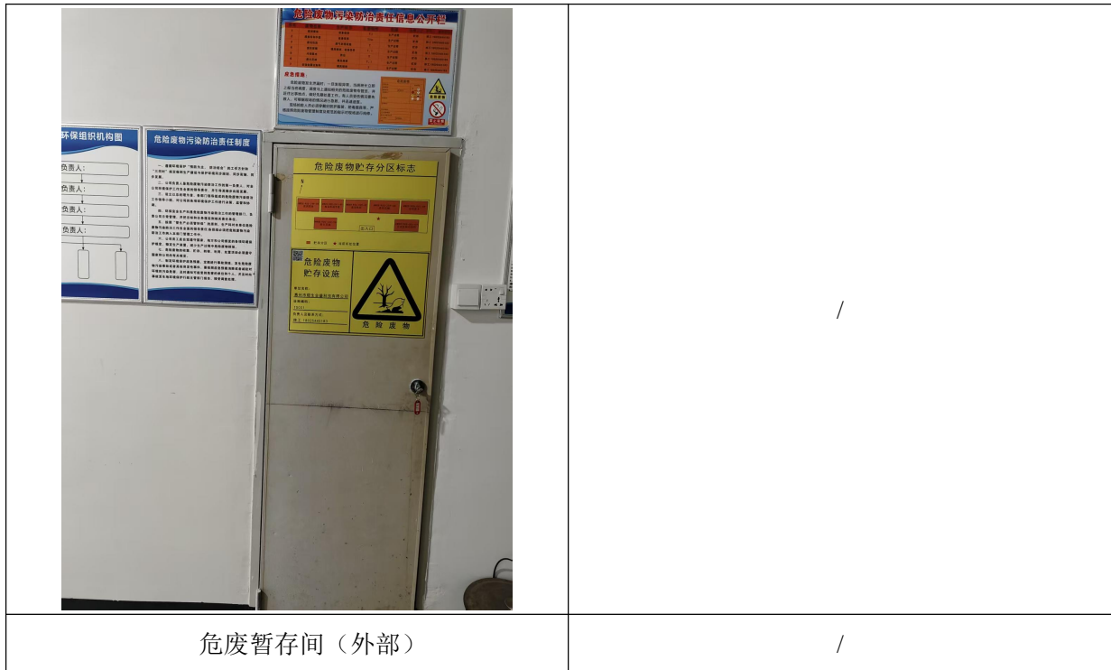
图 4-3 固体废物暂存场所
