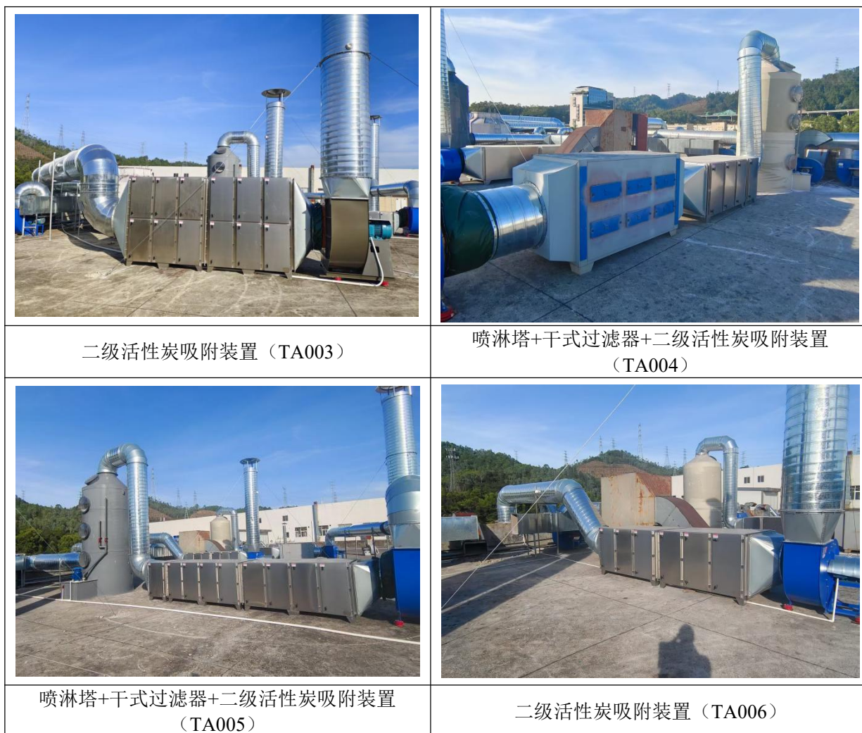
图 4-2 废气治理设施
