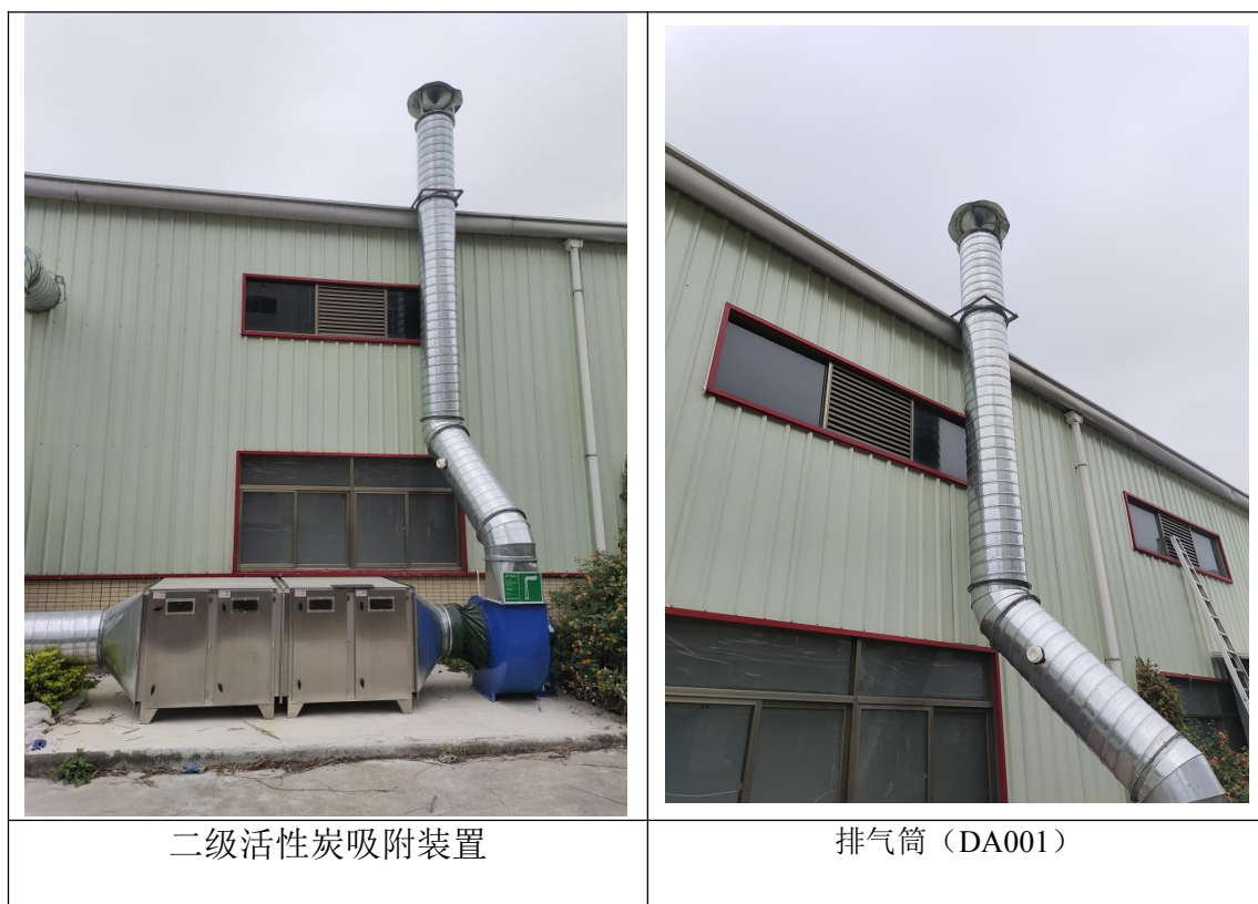
图 4-2 废气处理装置
