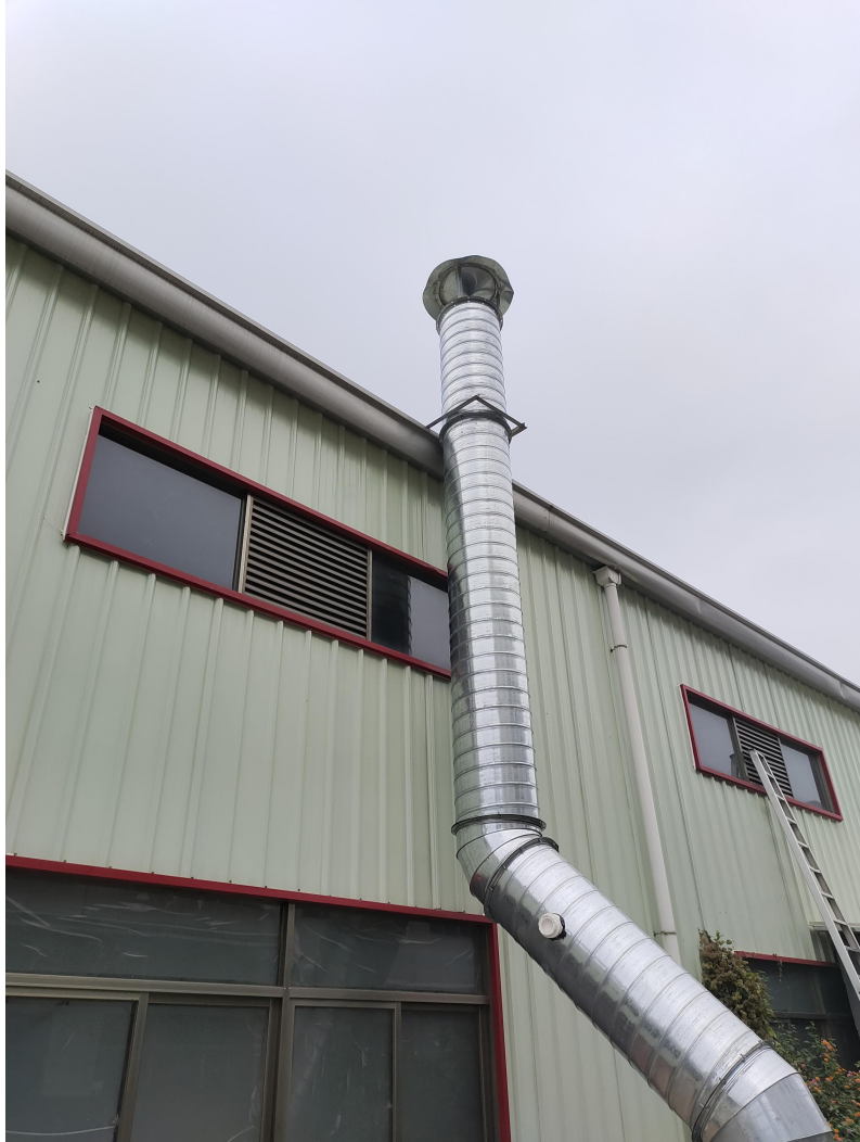
废气排放口（DA001）
